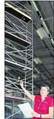
Wechsel der Beleuchtungsanlage in der Sporthalle Lobeda-West: Silke Hermann, die Elektroanlagen-Fachfrau vom kommunalen Eigenbetrieb KIJ, zeigt auf das schwere Rollgerüst, das für die Montagearbeiten benötigt wird. Foto: Thomas Stridde
