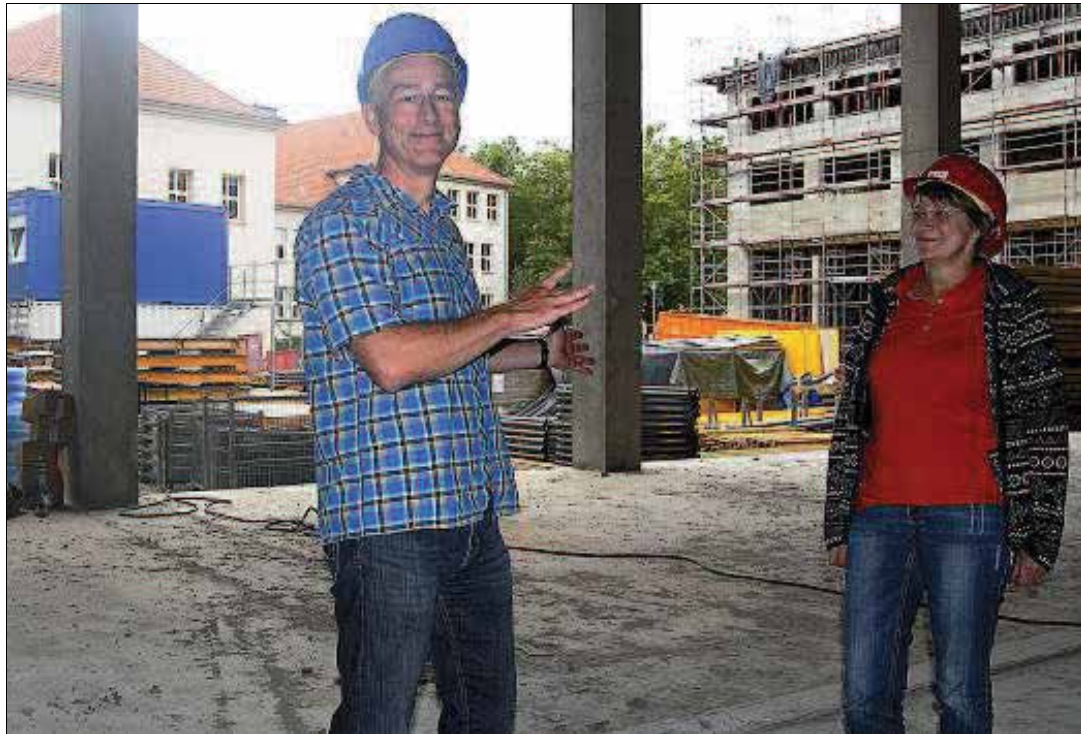
Mehr Platz für die Feuerwehr: KIJ-Abteilungsleiter Tilo Peißker und Projektleiterin Silke Hermann zeigten gestern auf der Baustelle des Gefahrenabwehrzentrums Am Anger, wo die 32 Stellplätze für Feuerwehrfahrzeuge eingeplant sind. Im Bildhintergrund zu sehen: der frühere Sitz des Angergymnasiums, wo heute das Stadtentwicklungsdezernat untergebracht ist. Foto: Thomas Stridde
