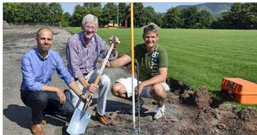
Von links: Symbolisch in die Hände nahmen Projektleiter Dirk Kindermann von Kommunale Immobilien, Ortsteilbürgermeister Volker Blumentritt und Koordinator Alexander Laube für den jetzt erfolgten Sanierungsbeginn der Sportanlage in Lobeda-West den Spaten in die Hände. Fotos (2): Michael Groß
