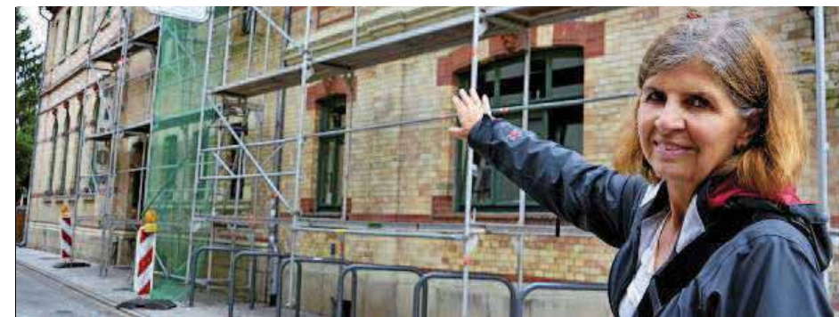
Die lange Seite des Schillerhofes mit seinen ursprünglich drei Gebäuden ist noch eingerüstet, wie Projektleiterin Waltraude Zellmann zeigt. Bis zum 28. August sollen die Arbeiten abgeschlossen sein. Dann geht es noch um einige Außenarbeiten, so etwa an der Zufahrt zum Parkplatz. Fotos (2): Michael Groß
