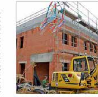
In diesem Teil des Anbaus soll die Schneiderei des Theaterhauses ihr neues Domizil erhalten.
