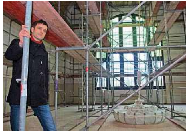
Die Aula steht voller Baugerüste: Sie sichert die Deckenkonstruktion, während in der Etage darüber gearbeitet wird. Im Bild Projektleiter Falk Wermann-Nerlich. Foto: Thomas Beier
